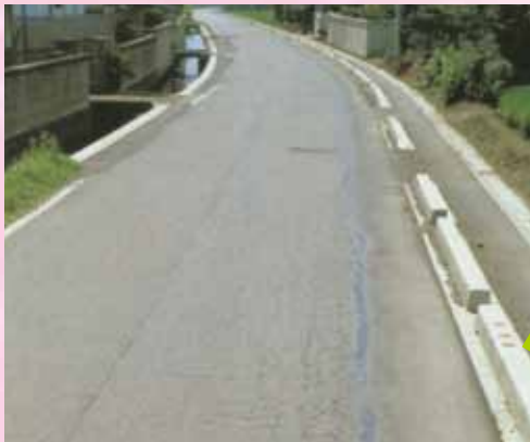
破損の進んだ施工前の既設舗装
