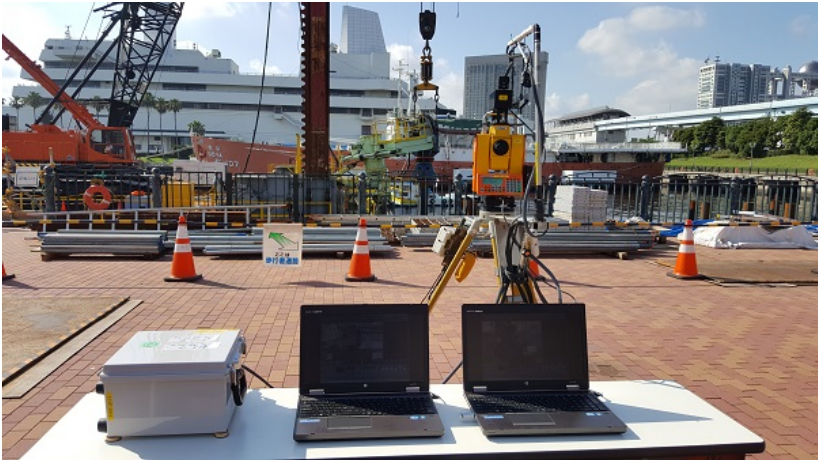
システム設置状況
