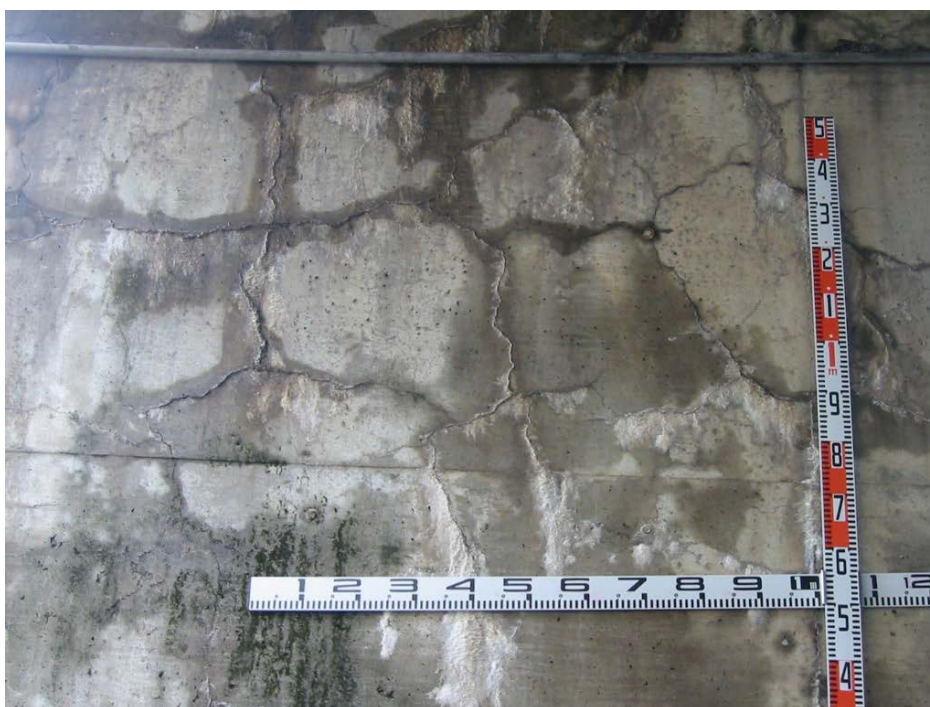
写真 2-2 アルカリシリカ反応による劣化例
