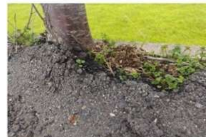
雑草の押し上げによる舗装部劣化部分
