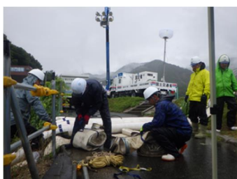
令和3年8月豪雨 活動状況 (広島県内)
