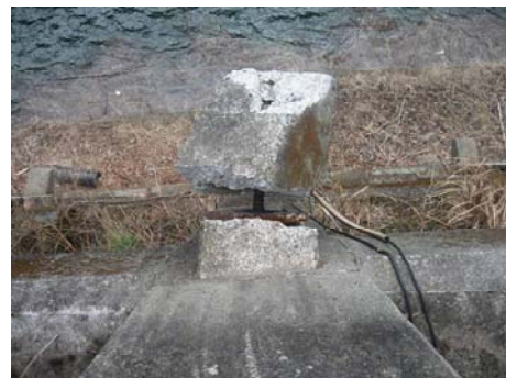
写真-1 腐食によって破断したアンカー
