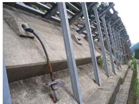
写真-2 地すべり滑動によって破断したアンカー
