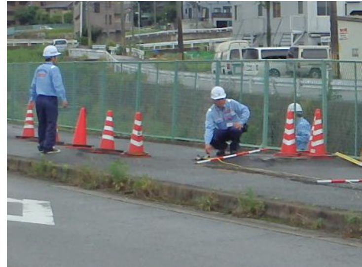
被災状況調査(枚方市)
