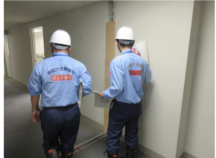
被災状況調査
