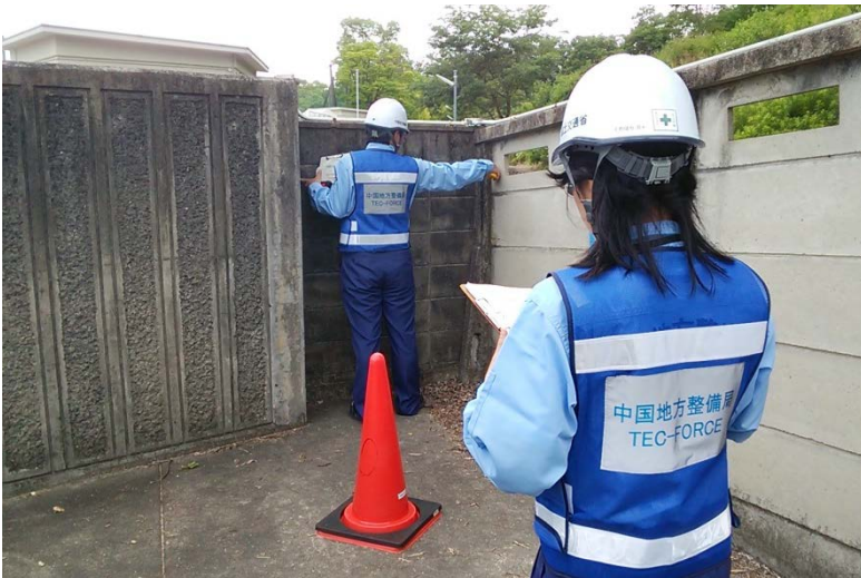
被災状況調査(茨木市内)
