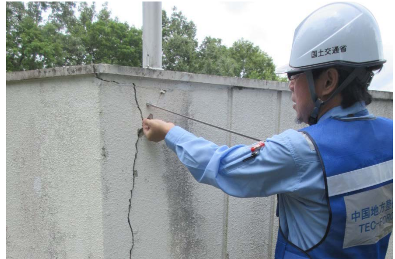
被災状況調査(茨木市内)
