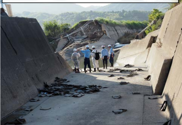
決壊箇所現地調査（高馬川：岡山県管理区間）
