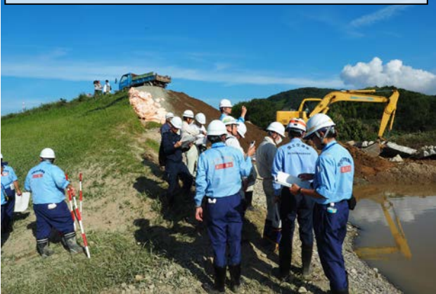
決壊箇所現地調査（小田川左岸 3k400 付近）
