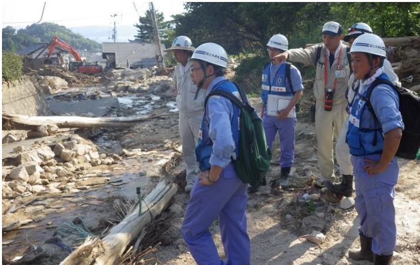
現地状況確認（呉市天応町）
