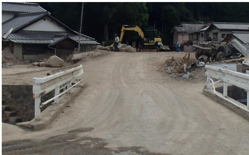
現地状況確認（坂町小屋浦）
