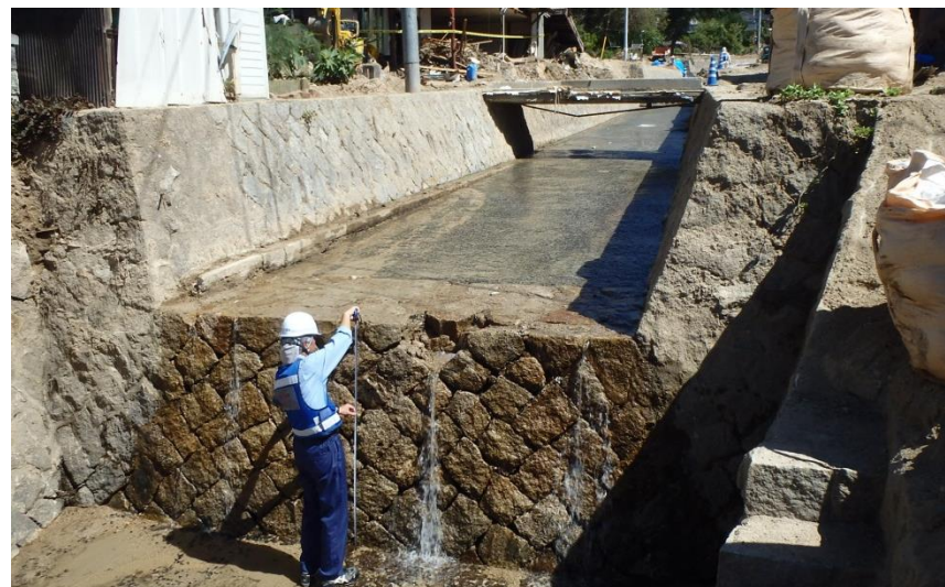
現地状況確認（呉市天応町）
