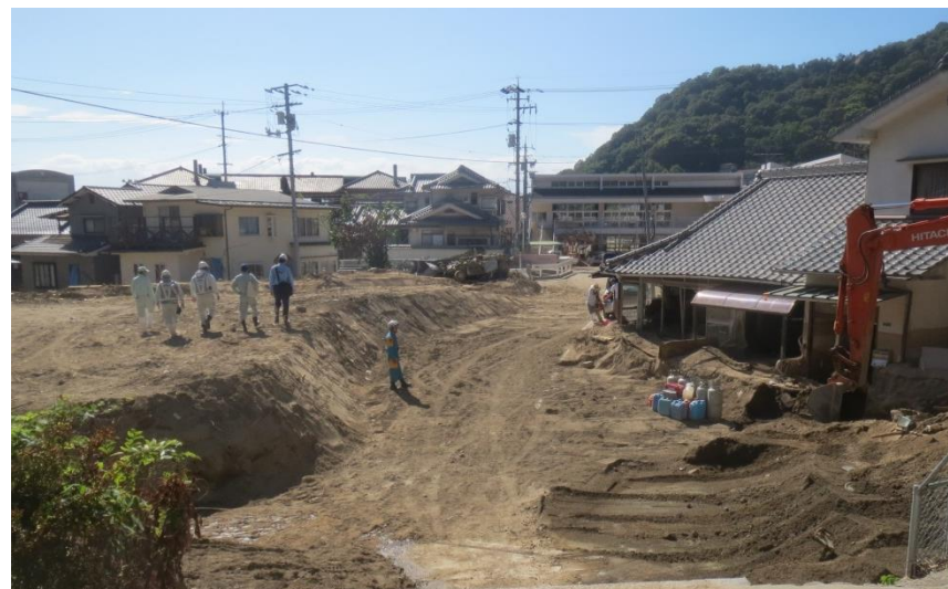
現地状況確認（坂町小屋浦）
