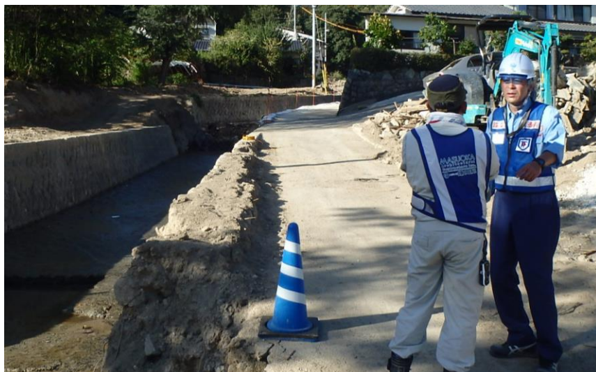
現地状況確認（呉市天応町）
