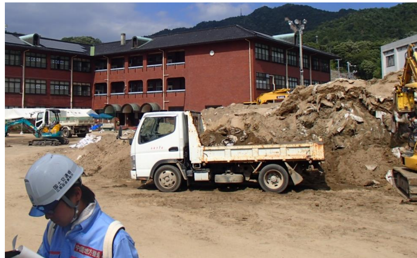
現地状況確認（坂町小屋浦）
