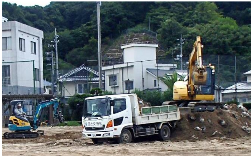
現地状況確認（坂町小屋浦）
