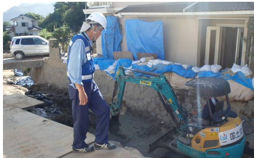
現地状況確認（呉市天応町）
