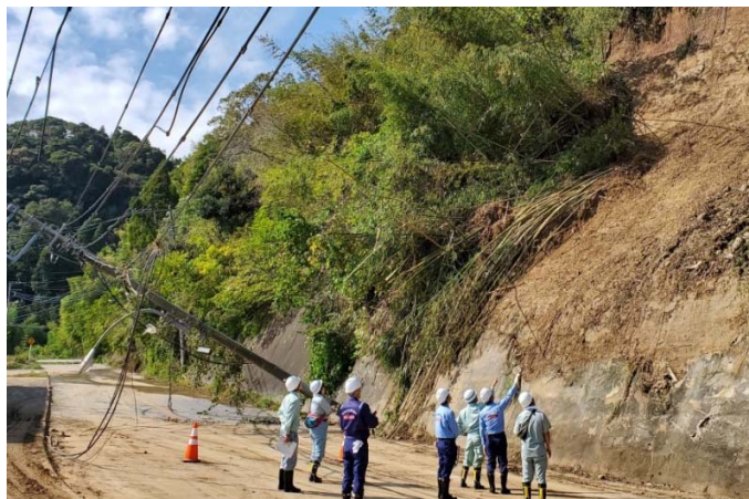
道路の被災状況を調査 (千葉県長生郡長柄町：道路班)
