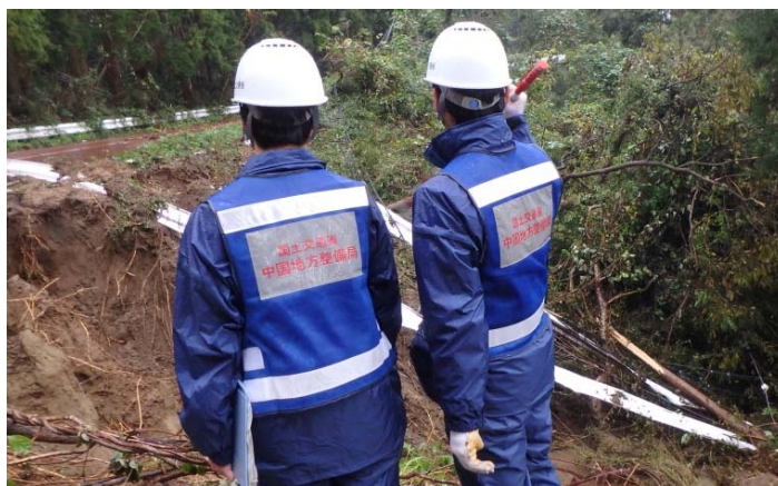
道路の被災状況を調査 （千葉県長生郡長柄町）
