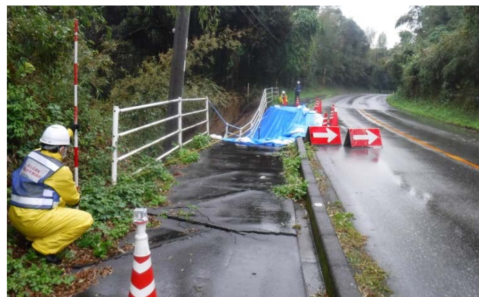
道路の被災状況を調査 （千葉県茂原市）
