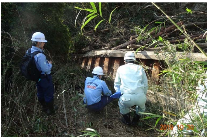
河川の被災状況を調査 (千葉県市原市：河川班)
