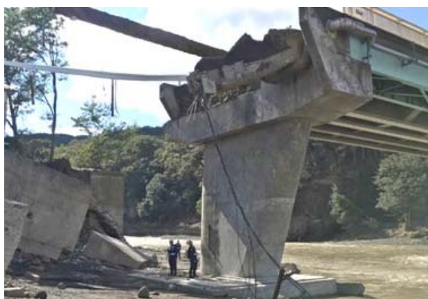
落橋箇所の被災状況を調査 (長野県東御市：道路班)
