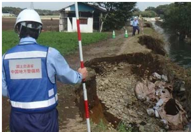
不老川の被災状況を調査 (埼玉県川越市：河川班)
