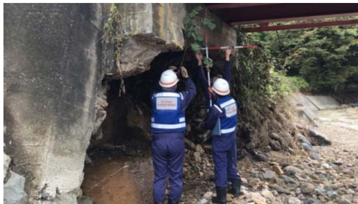
宮浦橋の被災状況を調査 （長野県南佐久郡佐久穂町：道路班）
