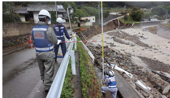
道路法面の崩落状況を調査 （長野県南佐久郡佐久穂町：道路班）
