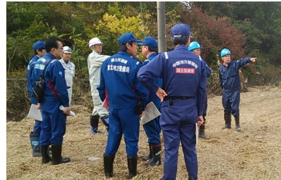
排水作業終了後の土砂撤去方法について打合せ (宮城県大崎市：高度技術支援班)
