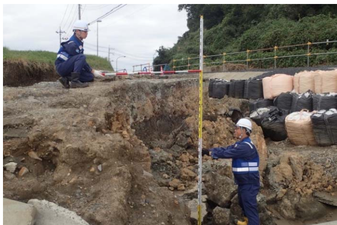
道路の被災状況を調査 (茨城県常陸太田市：道路班)
