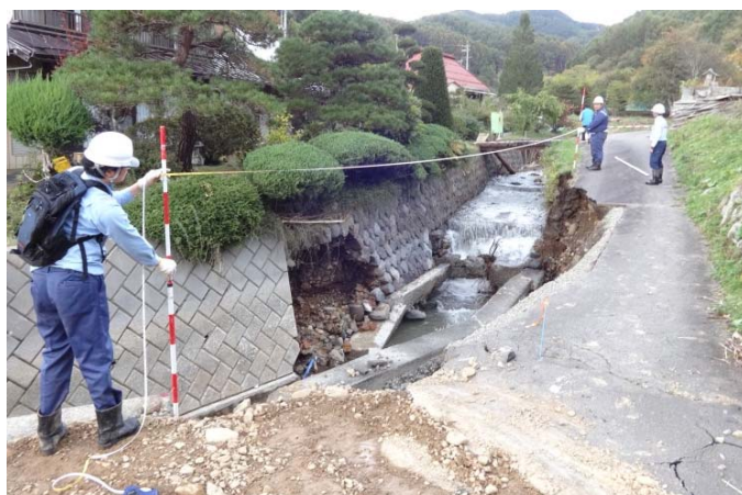
河川の被災状況を調査 (長野県南佐久郡佐久穂町：河川班)
