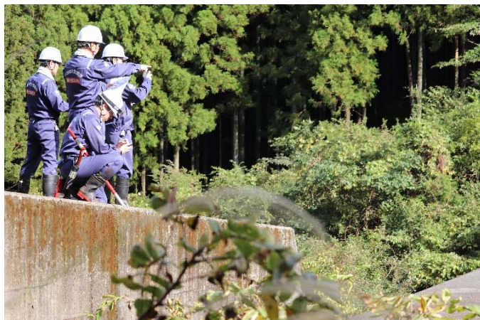
砂防ダムの被災状況を調査 (神奈川県南足柄市：砂防班)
