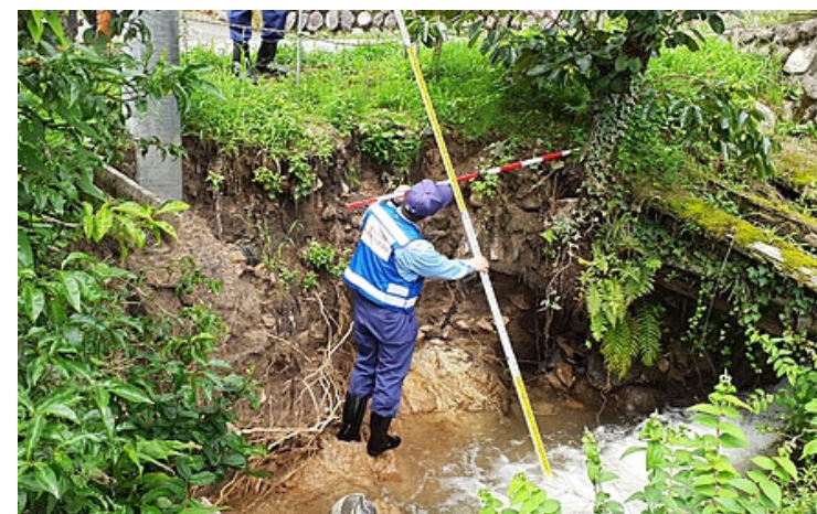
被災状況調査（河川③） きたひろしまちょうよしき （北広島町吉木）
