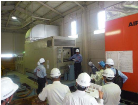
排水機場操作訓練
