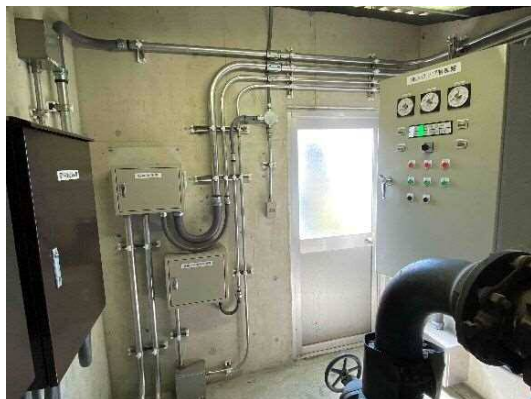
第2溝藤ポンプ
