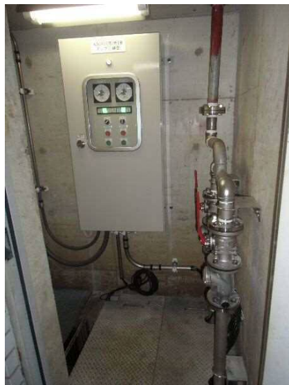
国道486号地下道排水ポンプ
