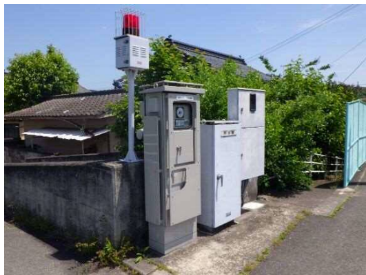
平成大橋東地下道排水ポンプ
