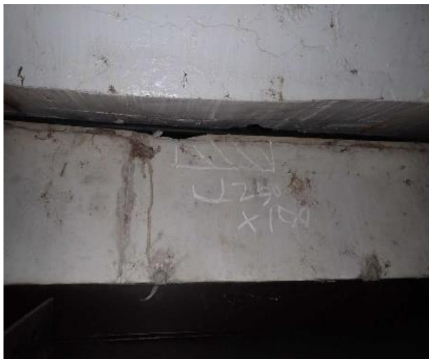
【損傷状況:床版のうき】
