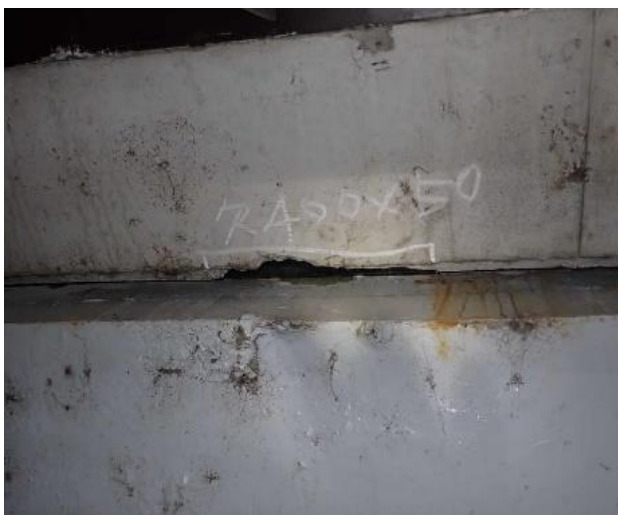
【損傷状況:床版の剥離・鉄筋露出】
