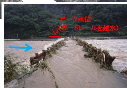
H30.7洪水 前原橋橋面部越水
