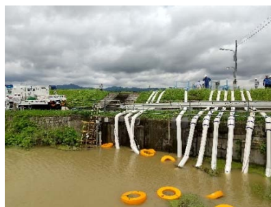
排水ポンプ車稼動状況
