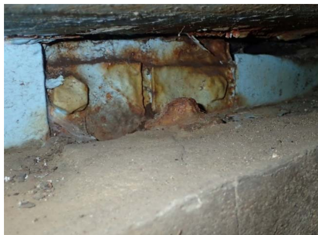
【損傷状況：支承の腐食】
