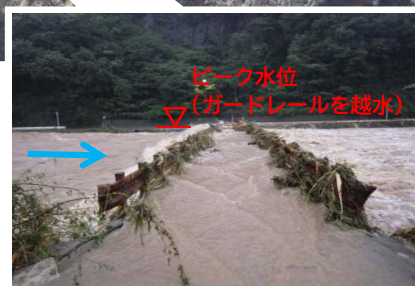
H30. 7洪水 前原橋橋面部越水
