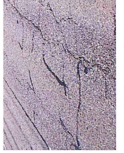
舗装のひび割れ
