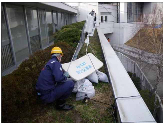
岩手県大槌町において、通信機能を確保 するため、Ku-SAT（衛星小型画像電 送装置）を設置し、運用を支援
