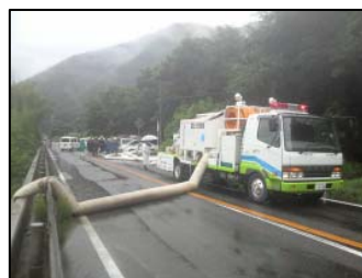
（排水ポンプ車稼働状況）
