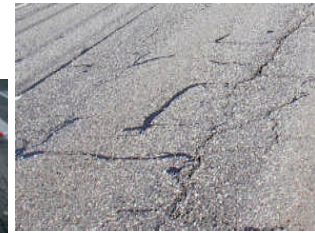
舗装のひび割れ
