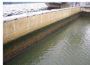
写真 2-3-6 主ゲートの劣化状況
