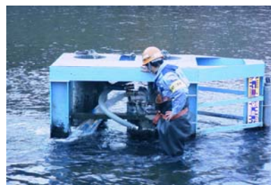
写真 5-2-24 水質観測装置の点検状況
