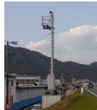
写真 5-2-11 CCTV の設置状況
