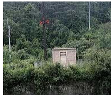
写真 5-2-17 八田原ダム放流警報設備
