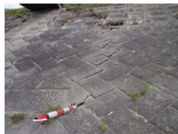
写真 2-3-2 老朽化による護岸のクラック
