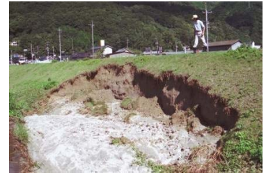
写真 2-3-10 洪水による堤防の損傷
