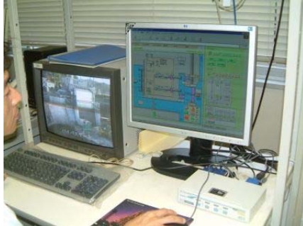
写真 5-2-29 排・取水門の遠隔操作状況
