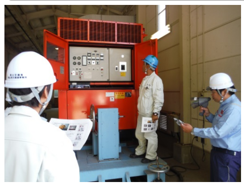
排水機場操作訓練
