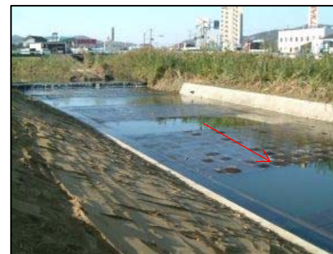
瀬戸川河川浄化施設
