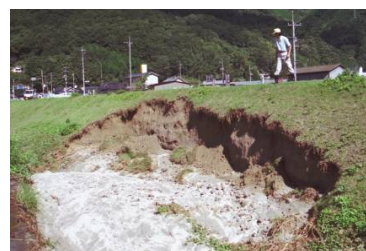
写真 2-3-10 洪水による堤防の損傷
