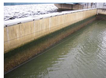
写真 2-3-6 主ゲートの劣化状況
