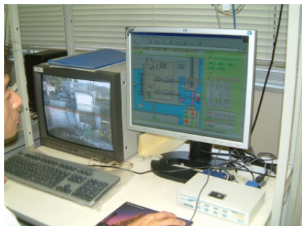
写真 5-2-29 排・取水門の遠隔操作状況
