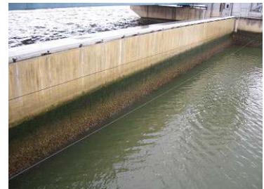
写真 2-3-6 主ゲートの劣化状況
