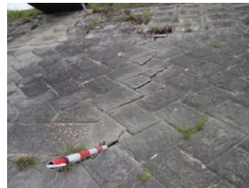
写真 2-3-2 老朽化による護岸のクラック
