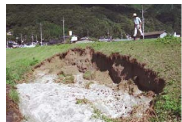
写真 2-3-8 洪水による堤防の損傷
