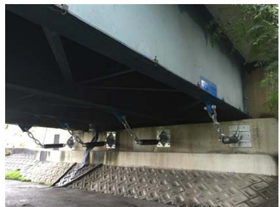
落橋防止装置
