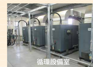
循環施設の稼働状況
