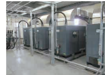
循環設備室 (循環用の気泡を送る設備)
