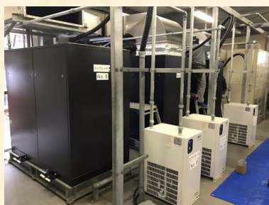
↑ 空気圧縮機（コンプレッサー） 湖内に設置している曝気装置にホースを通して空気を送ります。
