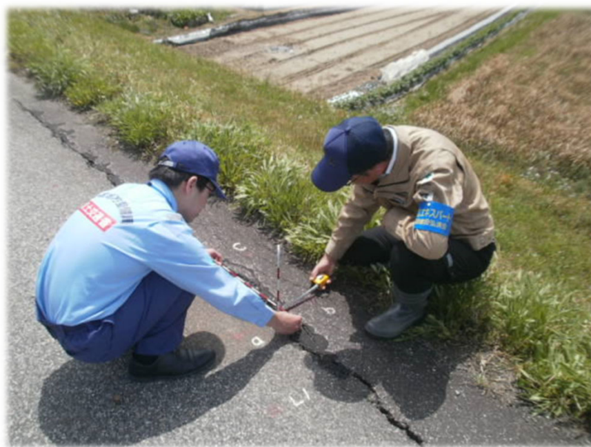
堤防頂部の亀裂
