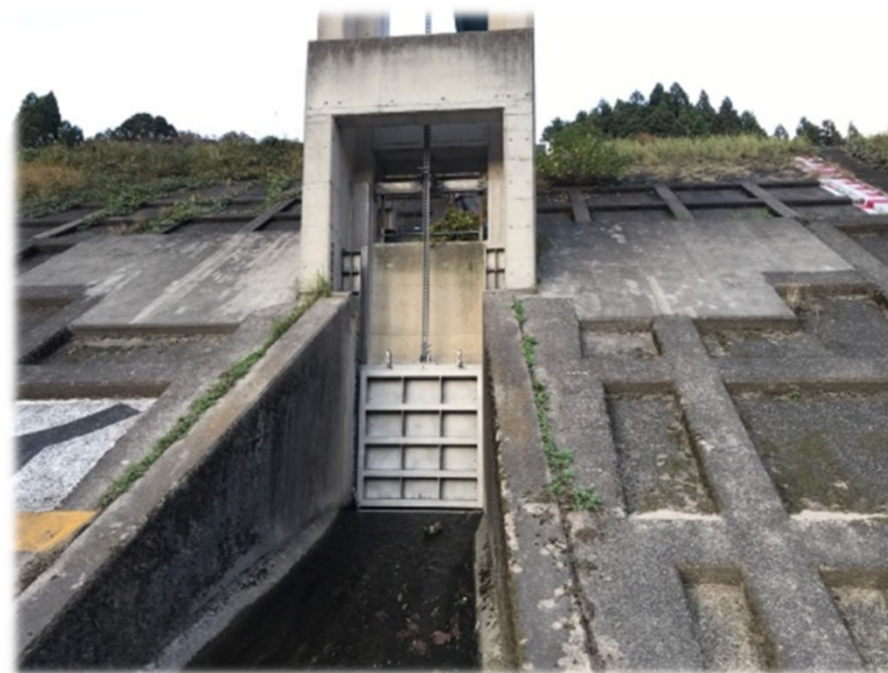
久座仁排水樋門(無動力化後)
