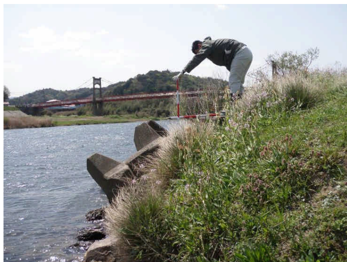
河岸洗掘状況（益田市飯田町）
