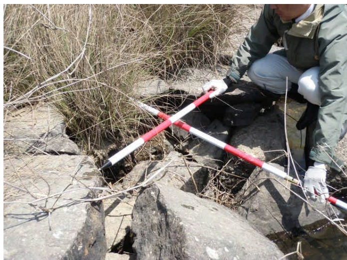
捨石一部流出（益田市高津町）
