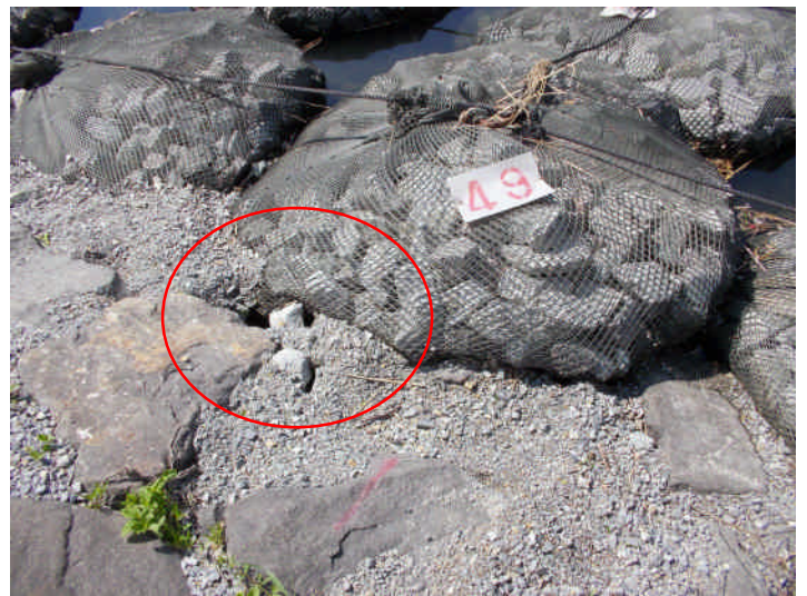
捨石護岸の隙間（川本町因原）
