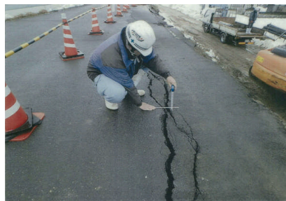
図3 堤防天端道路の亀裂
