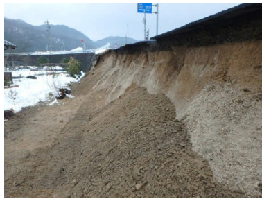
図2 川裏ブロック撤去後の崩落
