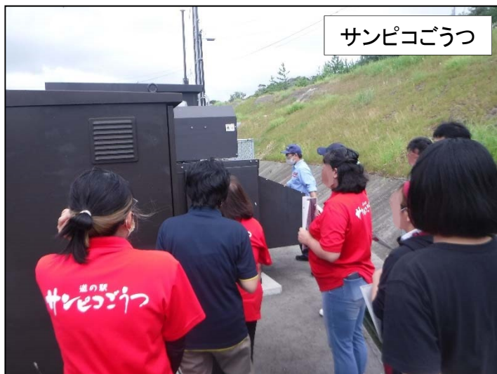
非常用電源設備の説明の様子
