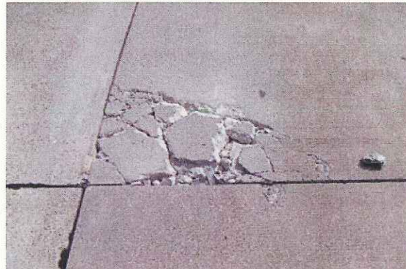
コンクリート舗装の角欠け
