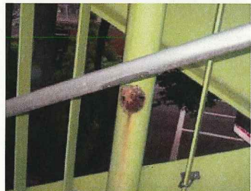
手すり、溶接部の破断(腐食を伴う)
