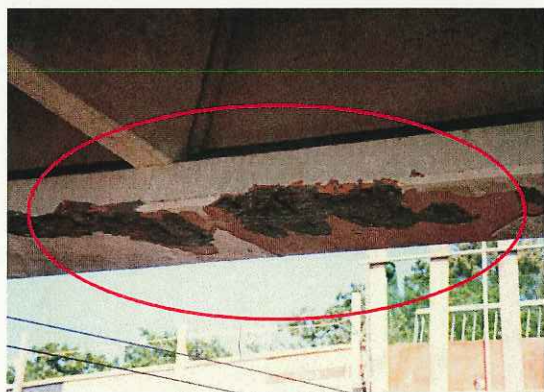
主桁、断面修復部
