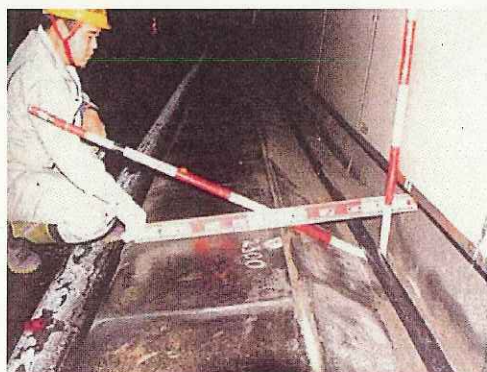
段差、ひび割れ、路肩変形の異常
