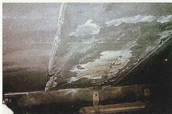
天井板コンクリートのうき
