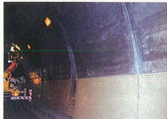
横断方向継目地の中間付近に発生したひび割れ
