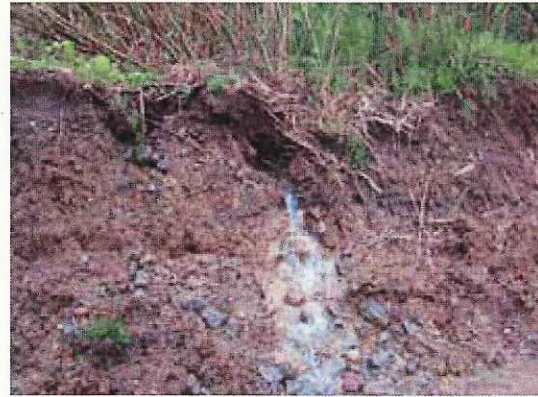
のり尻部の崩壊と湧水
