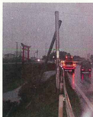
支柱溶接部の腐食による破断
