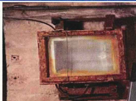
照明枠及び取付部材、著しい腐食
