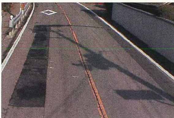
占用復旧跡の沈下
