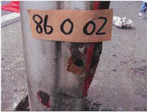
電気設備開口部の腐食
