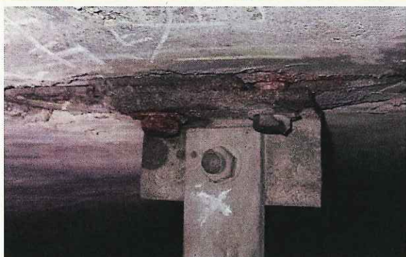
アンカーボルトの腐食、ゆるみ
