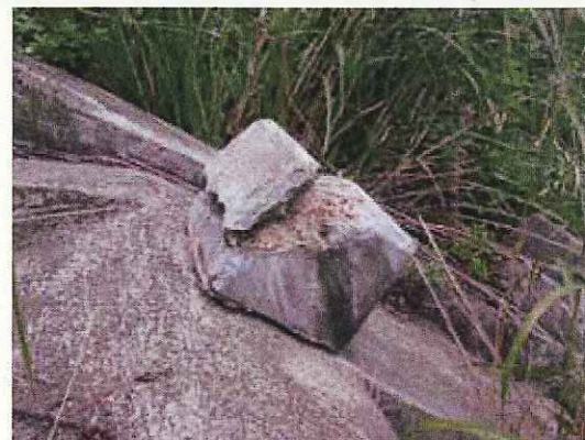
頭部コンクリートの破損
