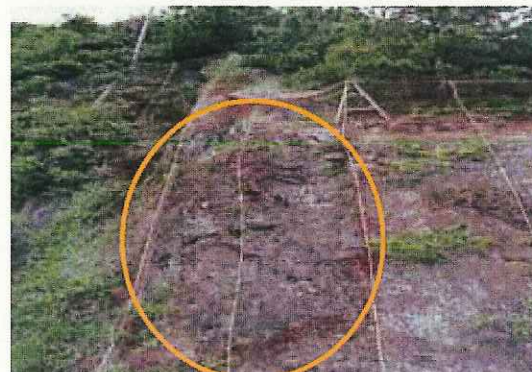
鋼部材の著しい腐食・破断
