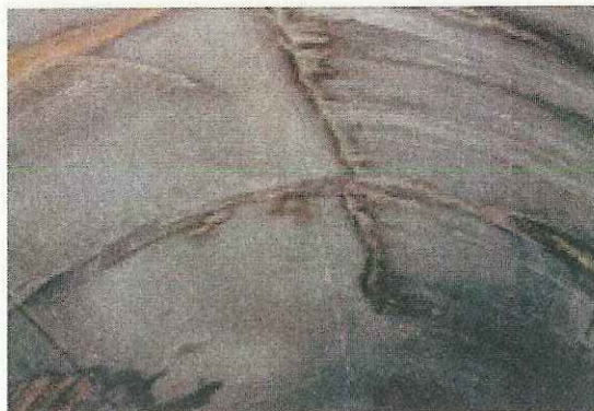
縦断方向のひび割れ
