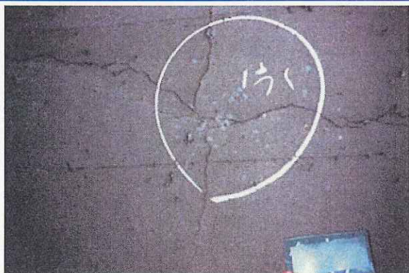
ひび割れによるブロック化
