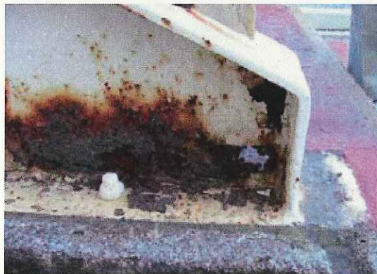
主桁(階段)、著しい腐食(板厚減少及び断面欠損)
