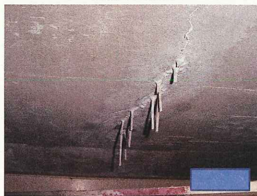
床版(遊離石灰のつらら状結晶)
