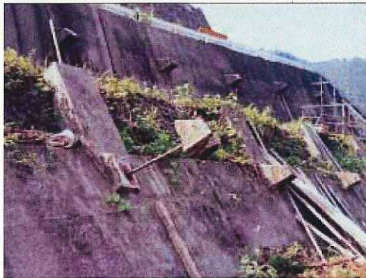
アンカーの飛び出し
