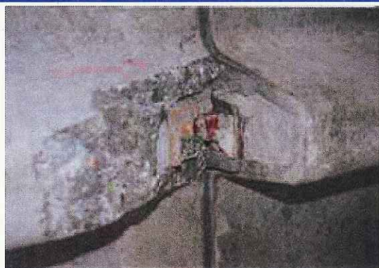
シェッド、コンクリートの剥離
