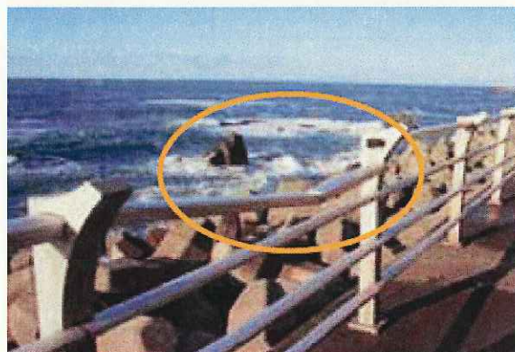
防護柵横梁、破断・変形
