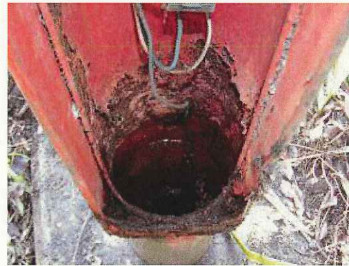
支柱内部に雨水が滞水
