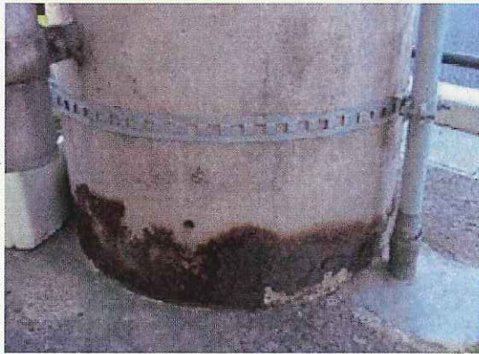
橋脚、著しい腐食(膨張)
