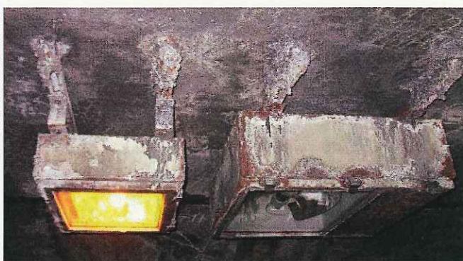
照明灯具及び取付金具の腐食
