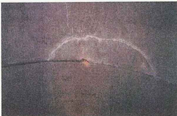
横断方向目地部の弧状のひび割れ
