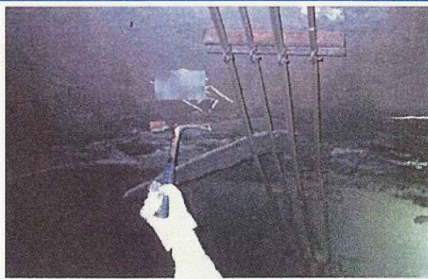
補修モルタルの剥離
