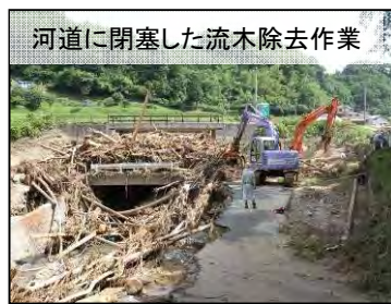
平成22年7月 豪雨 (広島県庄原市)
