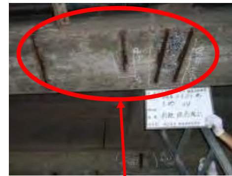
剥離・鉄筋露出 9
