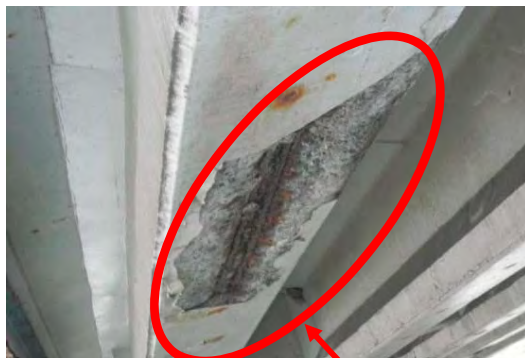
剥離・鉄筋露出
