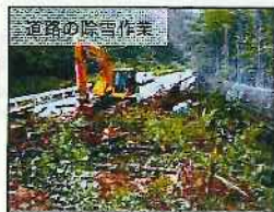
平成21年8月9日 台風9号 (岡山県美作市) 「建設業社会貢献活動事例集」より
