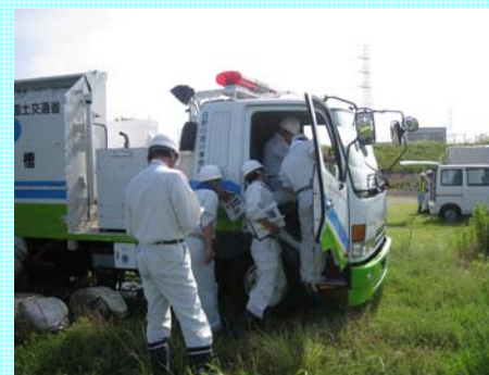
運転席で、排水ポンプ車が稼働するための切替えを行っている状況
