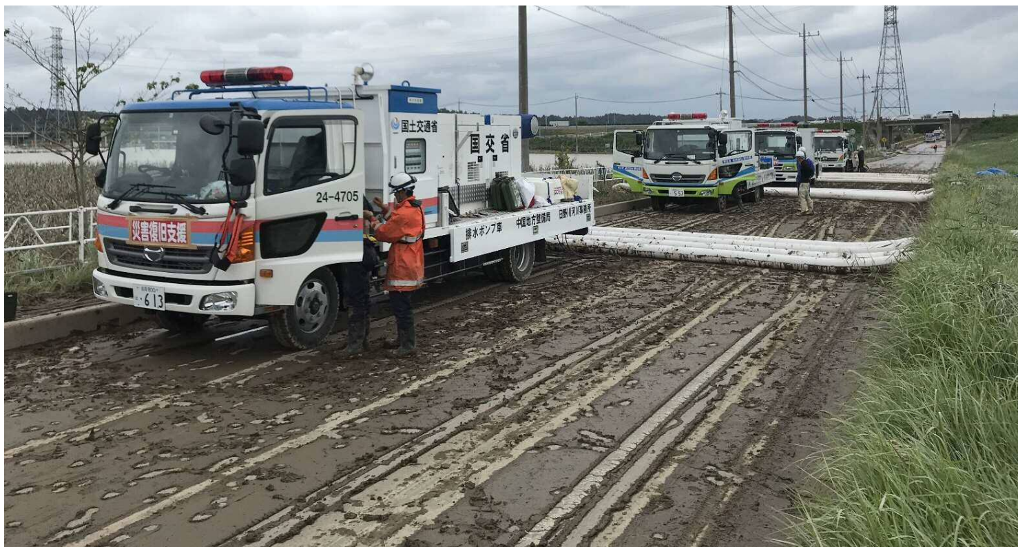
排水ポンプ車の稼働状況
