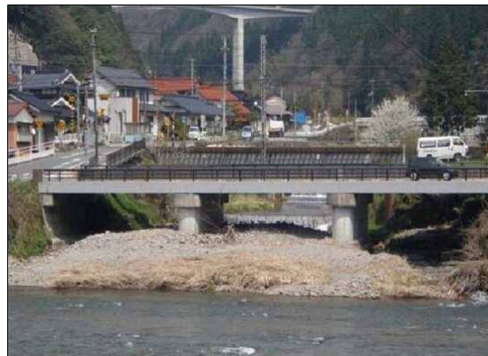
日野川合流点で流出土砂が堆積(小江尾川)
